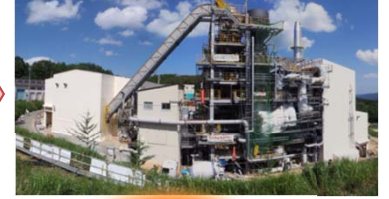
飯館村小宮仮設焼却炉
