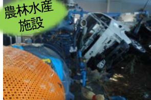
八沢排水機場（相馬市）
