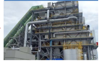
浪江町仮設焼却炉
