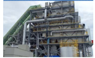
浪江町仮設焼却炉
