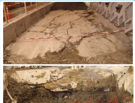
インバートコンクリート損傷状況
