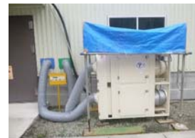
負圧集塵機設置状況
