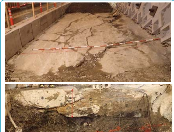
インバートコンクリート損傷状況
