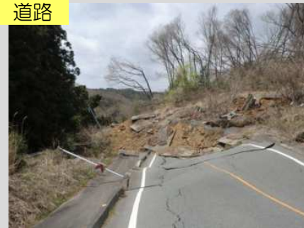
いわき石川線の被害状況(4/12)
