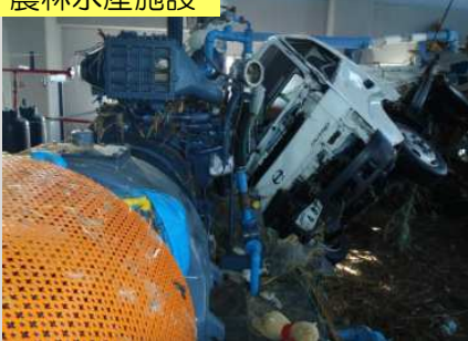
八沢排水機場の被害状況(3/29)
