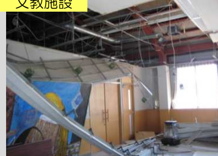
岩瀬農業高校の被害状況(3/15)
