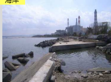
岩間・佐糠地区海岸の被害状況(5/26)
