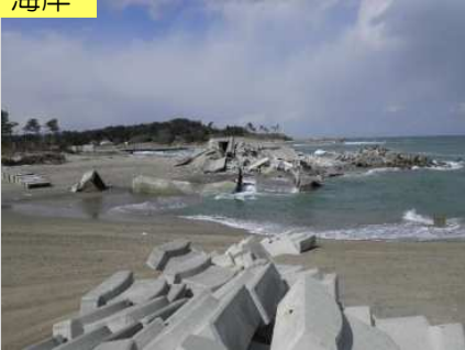
木崎海岸の被害状況(3/29)
