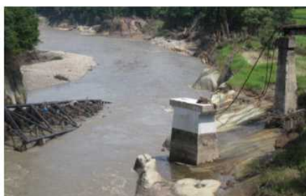
流出した第七只見川橋梁 (金山町)
