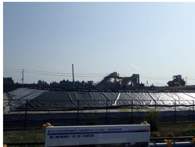
土壌貯蔵施設の稼働状況の確認
