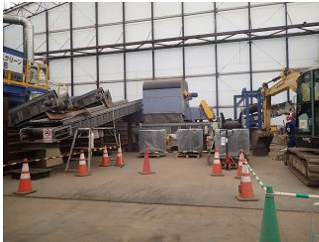
受入・分別施設の稼働状況の確認
