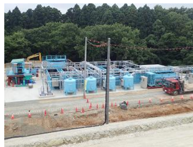
土壌貯蔵施設の稼働状況の確認
