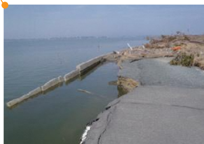
治山施設が倒壊した大洲地区
