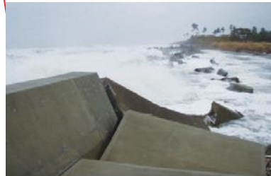
堤防が決壊した北海老地区
