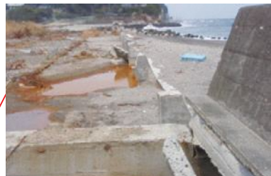
堤防が決壊した浅見川地区
