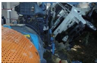
トラックが流れ込みエンジンが破損（八沢排水機場）
