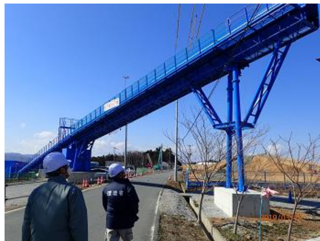
ベルトコンベアの稼働状況の確認
