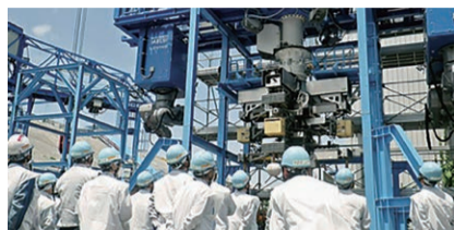
立入調査の様子(排気筒切断装置)
