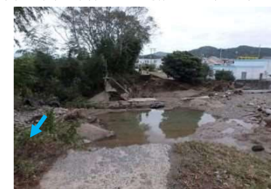
令和元年東日本台風により破堤した下平窪の様子
