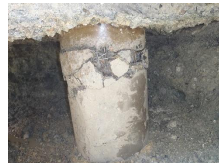
基礎杭の破損
