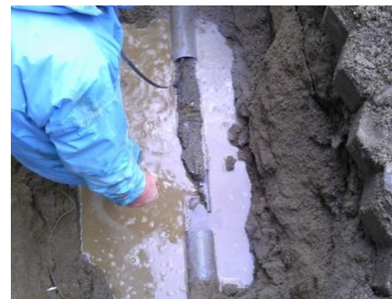
給排水管の破損
