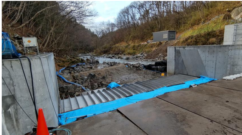
信夫山・光大寺小水力発電所 取水部 SR堰 (鋼製起伏堰 (ゴム袋体支持式))
