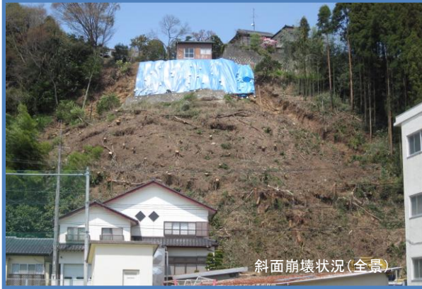
工事着手前(斜面崩落状況)
