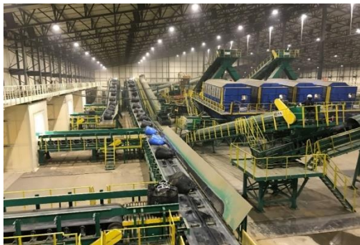
受入・分別施設(稼働中)
