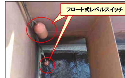
【PH調整槽内部_液位は低い状態の時】
