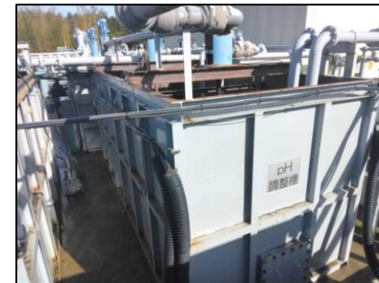
【PH調整槽外観】
