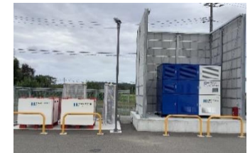
水素燃料電池の設置状況 於：TTK鹿島営業所（R5.9.27）
