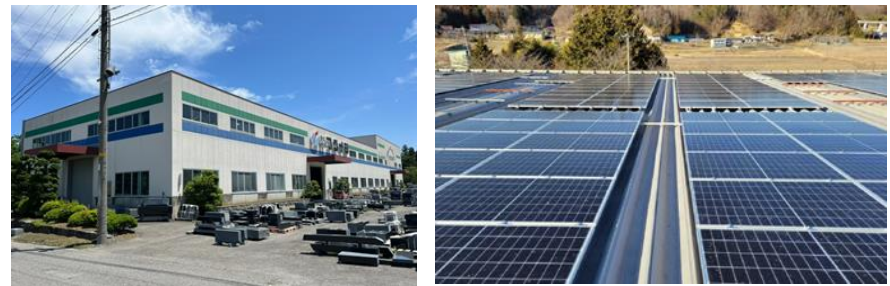
【(株)フクイシの工場に設置された太陽光発電設備】
