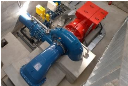
【信夫山・光大寺小水力発電所 水車発電機】
