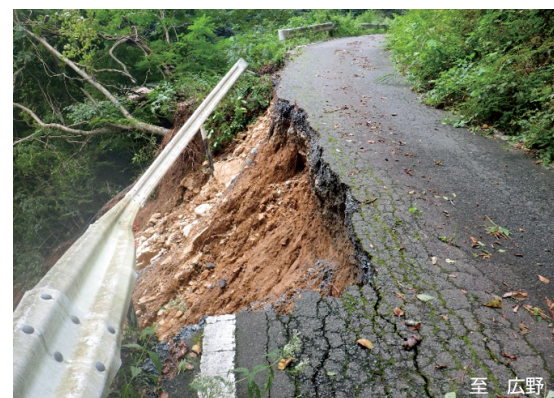
▲大雨により路肩が崩落した上戸渡広野線(広野町)
