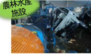
八沢排水機場（相馬市）
