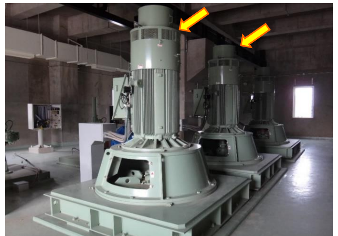
第2スクリーンポンプ棟主ポンプ （右岸幹線の下水を揚水するポンプ）
